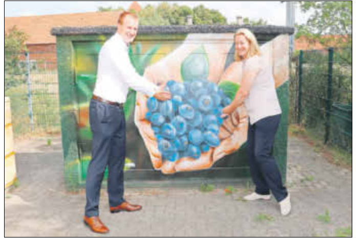
Carsten Birkholz (Avacon) und Bürgermeisterin Nicole Golz vor dem Trafohäuschen (Seite zur B1)
