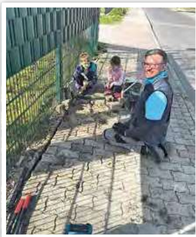
Heiko Springer, im Einsatz für den Moskitoclub e. V., hatte wohl die stärkste Unterstützung von allen bei der Sanierung des Gehweges in Richtung Sporthalle.
